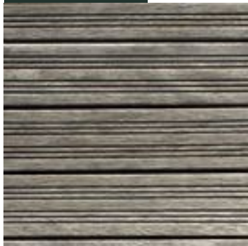
経年劣化した古いデッキ材
