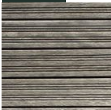
経年劣化した古いデッキ材
